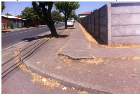
Fotografía 17: Situación de aceras en Huépil
